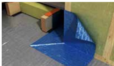
DAFA udvendigt hjørne ved gulv.
